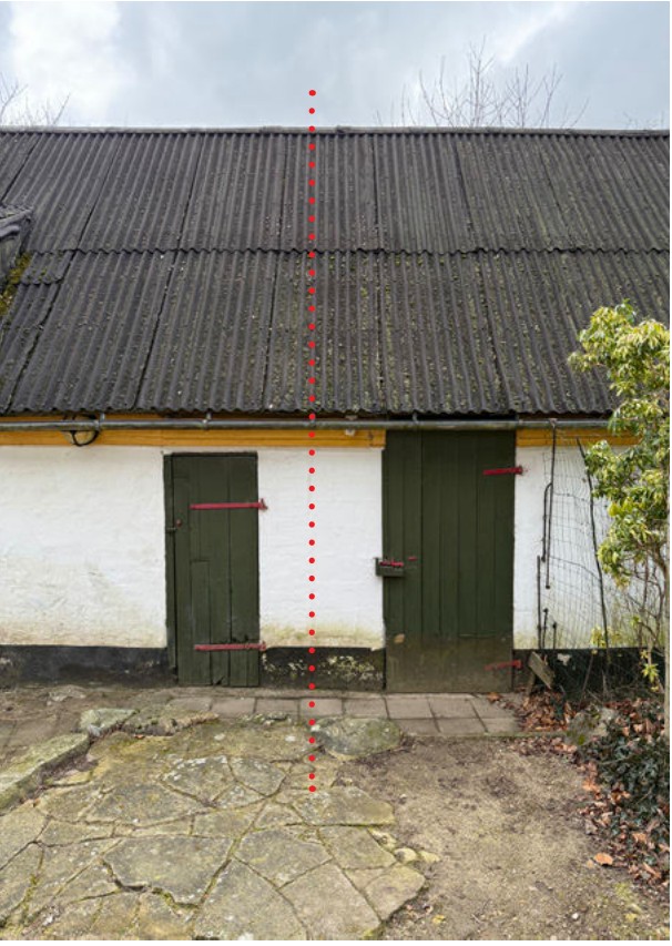
Eksisterende foto Bygning 2 med bølgeeternit (asbest) fremstår uoriginalt og ikke iht. vurd. af bevaringsværdi dateret 1989. Her ses en klar overgang i bygningens perioder (ca. midt i bygningen). Oprindelig byg. med alm mursten og udvidelse i større blokke (tilbygning med blokmur til venstre)
