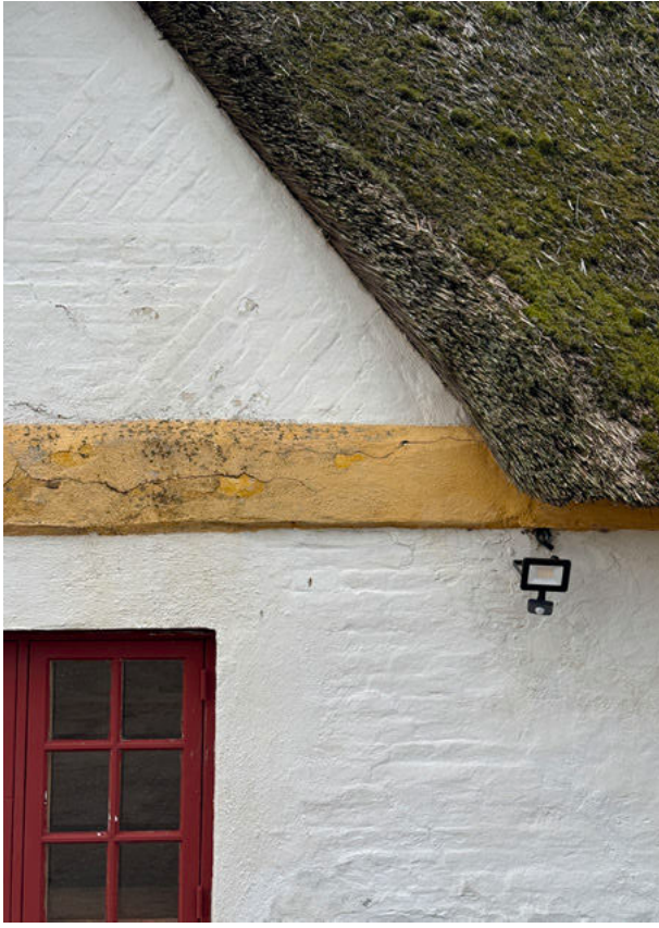
Eksisterende foto Eksisterende fine detaljer i murværk omkring gavlene op det eks. stuehus (1). Sammenbygning ses omkring “det gule bånd”.
